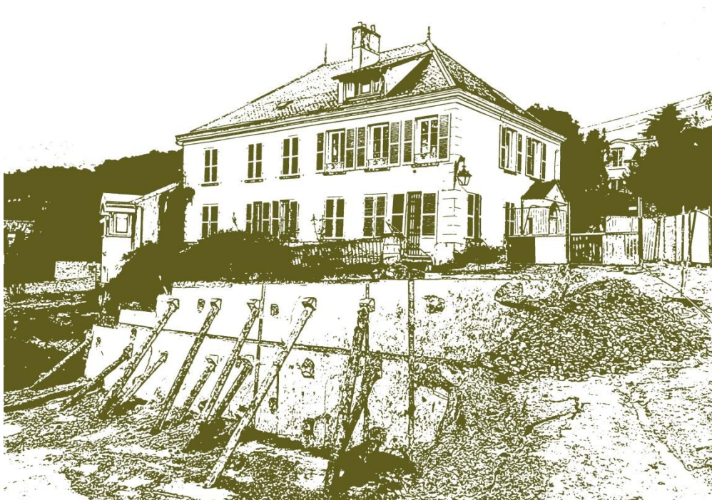
Perception de Chevreuse dite maison André Claveau en cours d'effondrement - Février 2018
